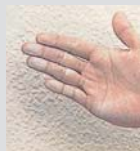
紫外線などによる塗装の劣化で手に粉が付くようになります。
